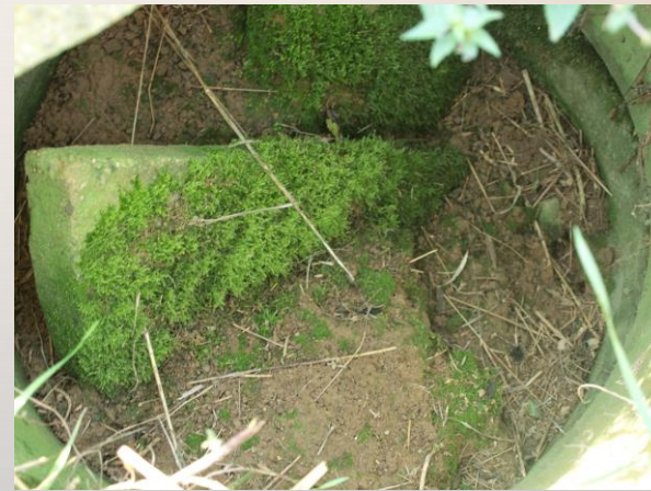
Poškozená šachtice (lokalita Břestek-foto L. Běhůnek, 2019)
